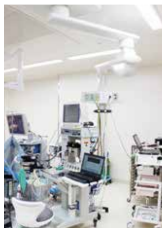
天吊りペンダントから全身麻酔器に医療ガスの配管が接続されている。
